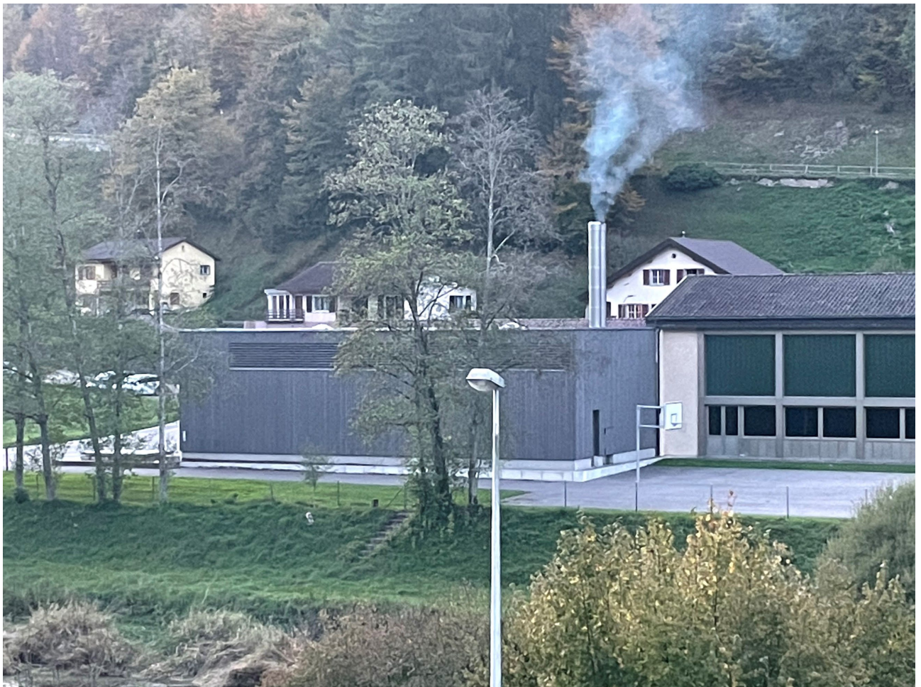
La centrale de chauffe au Chemin des Saules
