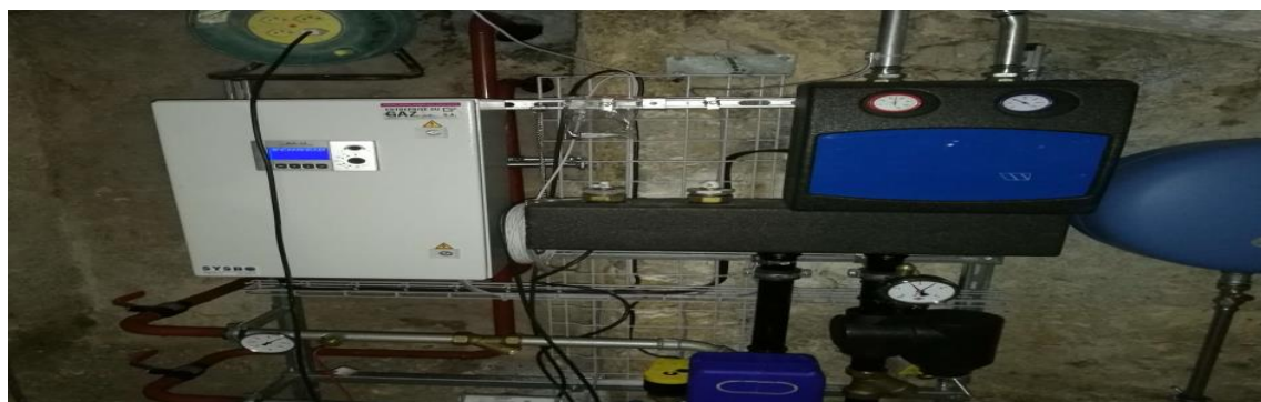
Sous-station reliant le réseau au bâtiment
